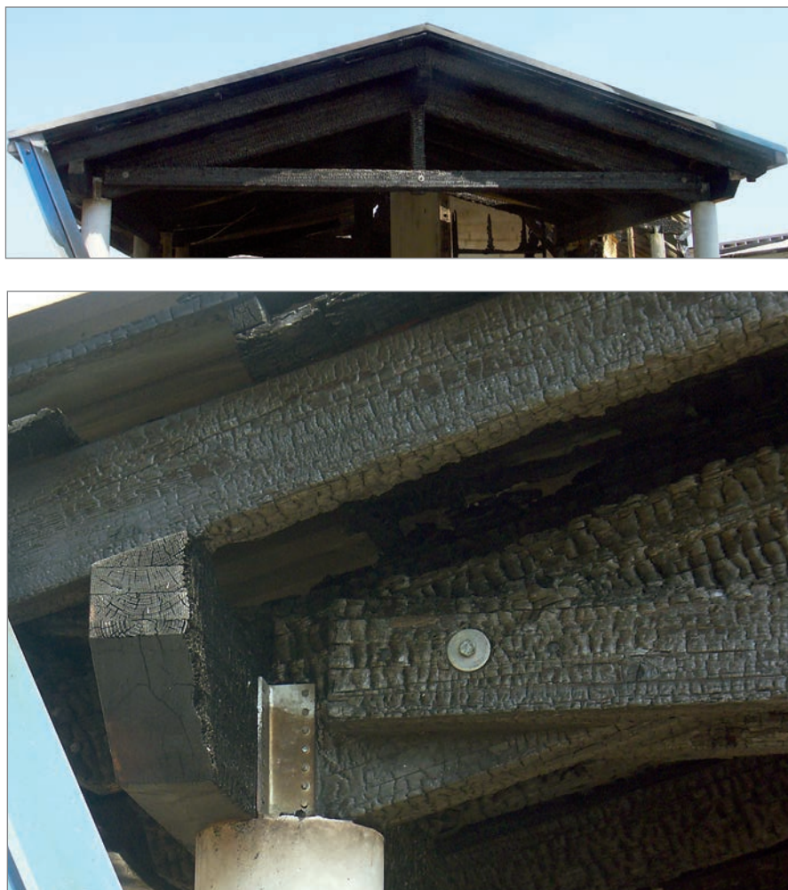
Figura 4.11. Struttura in legno rimasta vittima di un incendio senza conseguenze per gli occupanti.
